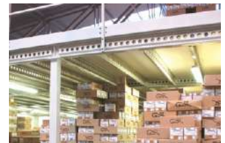
Unter der Bühne installiertes Beleuchtungssystem
