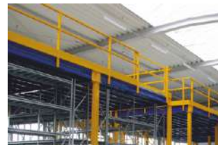
Geländer zum Schutz vor Stürzen von der Lagerbühne
